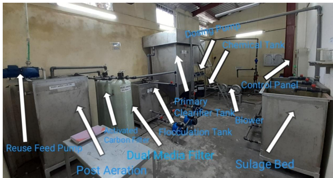
Fig: 9.1 ETP (Effluent Treatment Plant).
