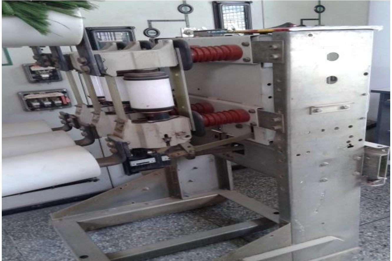
Fig: 4.13 SF6 circuit breaker
