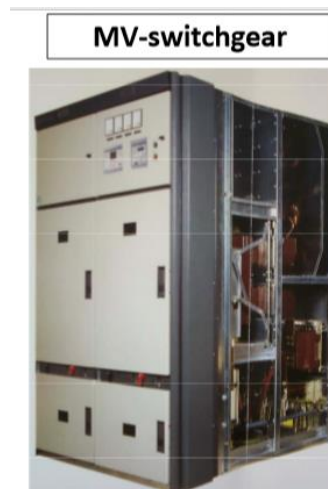
Fig: MV Switchgear
