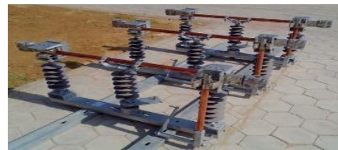
Fig: Earth Switch
