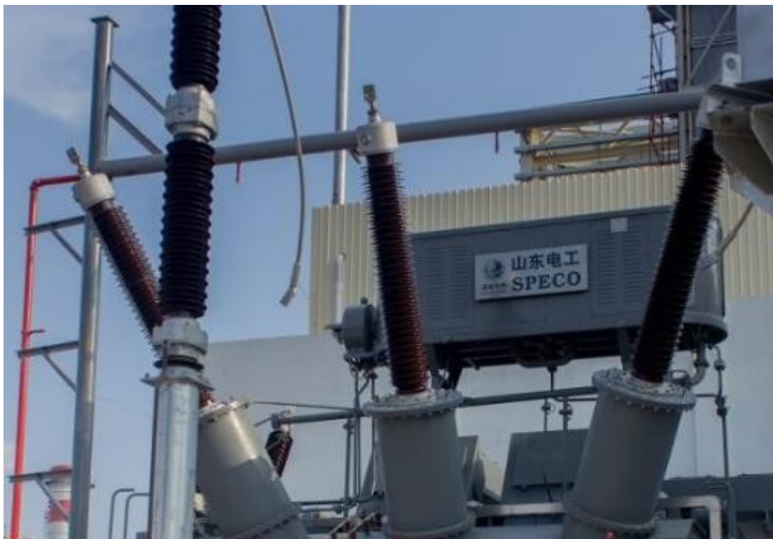
Fig. 6.11. 230 KV CT at GPS
