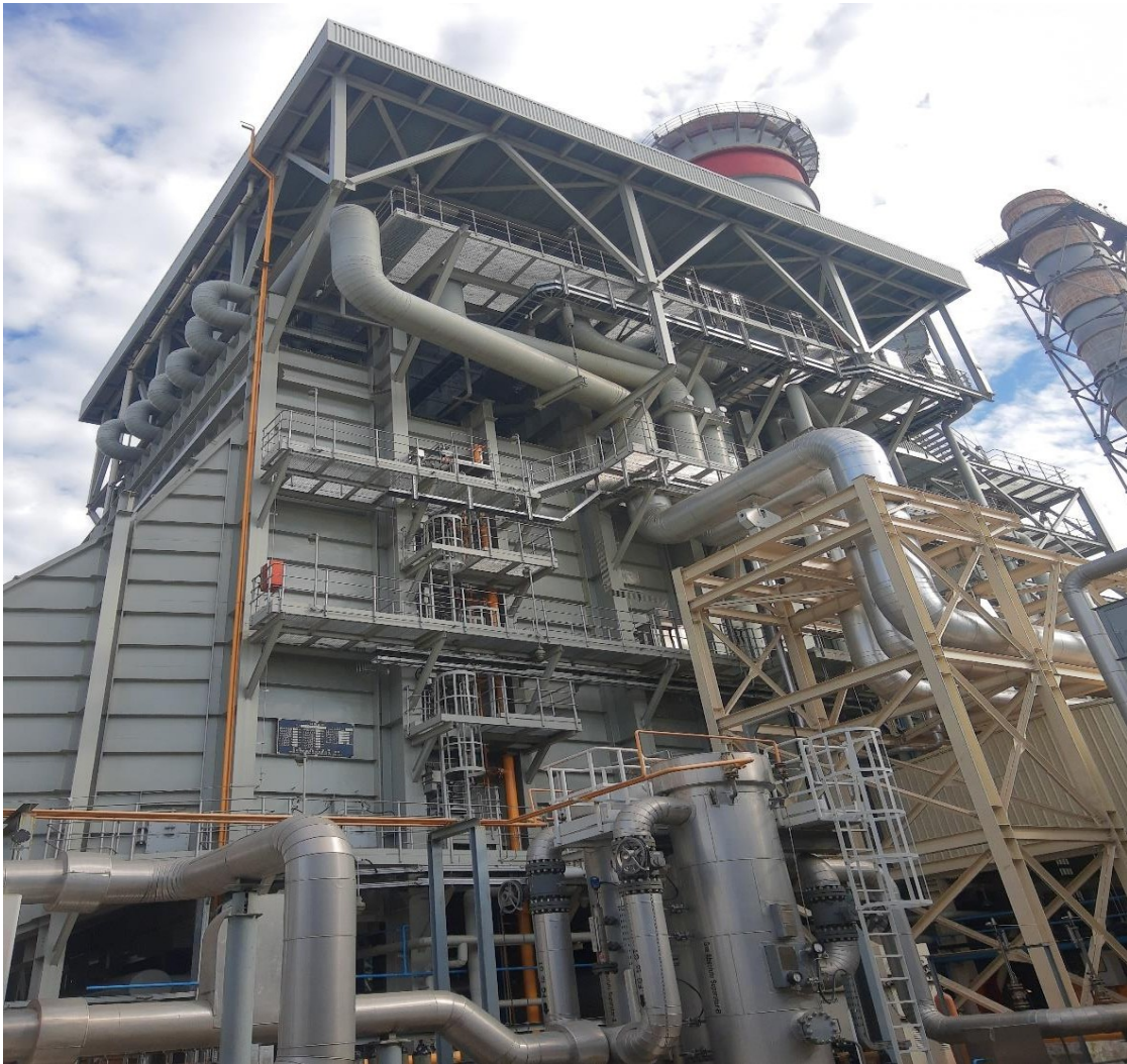
Fig. 2.4. HRSG at GPS unit-4
