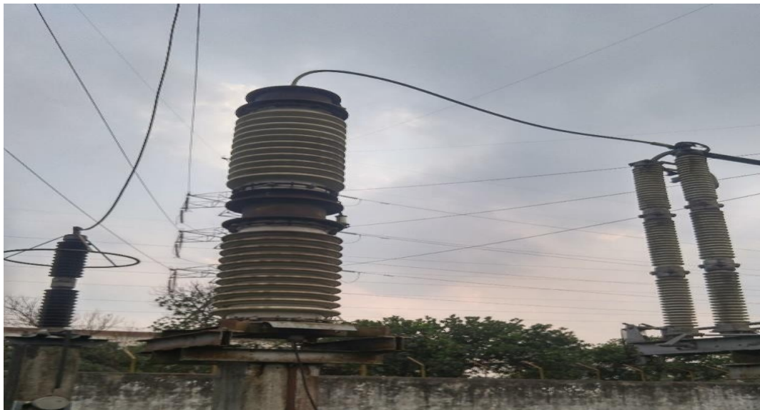
Fig. 6.12. 230 KV PT at GPS
