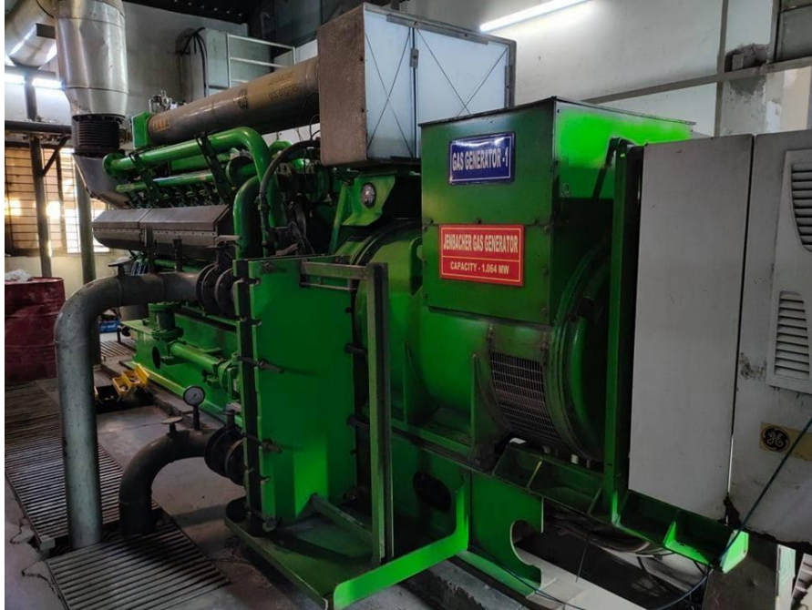
Fig: 3.5- Gas Generator
