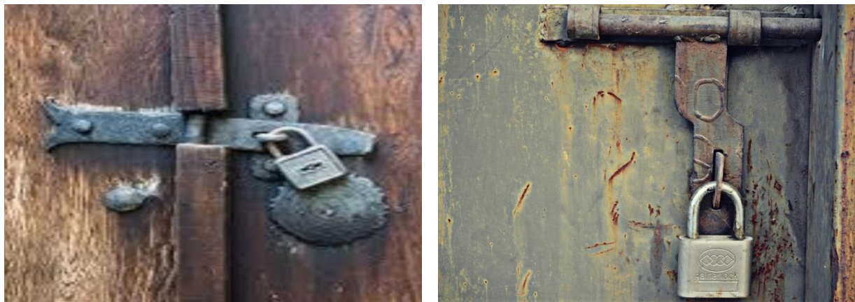
Fig: 2.1 Old door lock system
