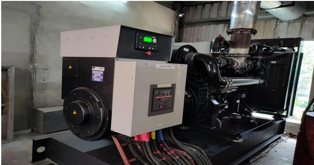
Fig: 4.3 Diesel generator
