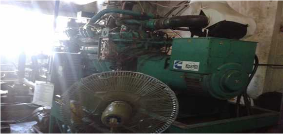
Fig: Gas Generator
