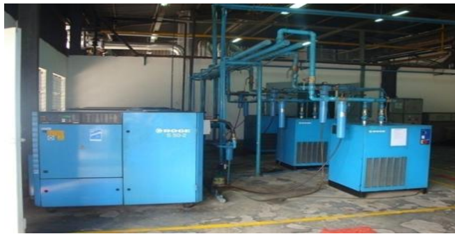
Fig: Air compressor
