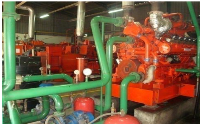
Fig: Gas generator
