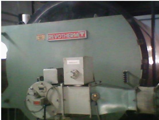
Fig: Boiler (Revothem)
