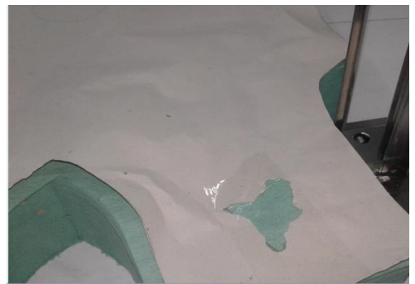
Fig: 3.4.9 Wrong cutting
